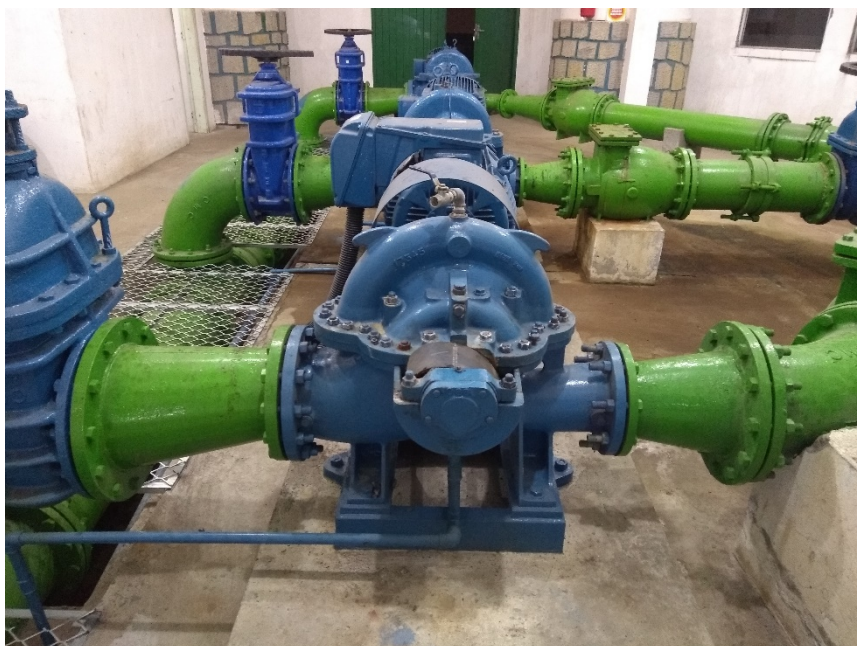
Figura 1: Vista Geral Conjuntos Motor-bomba
