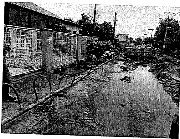
Imagem 02: Sistema montado e verificação da necessidade de rebaixamento, visto a área alagadiça.
